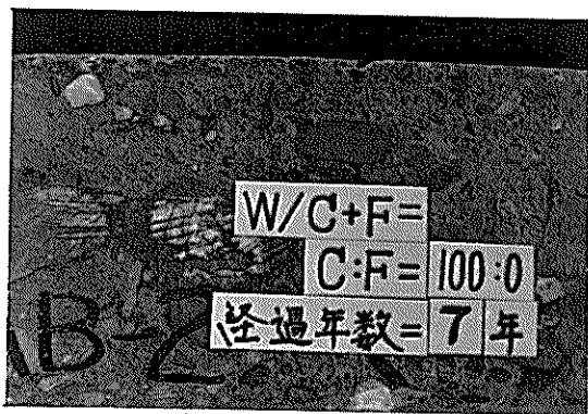
図-4.2 コンクリート表層からの中性化の状況(1) (普通コンクリート, 八代港, 舗装ブロック)
