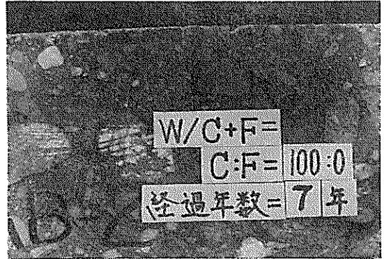
図-4.2 コンクリート表層からの中性化の状況(1) (普通コンクリート, 八代港, 補装ブロック)
