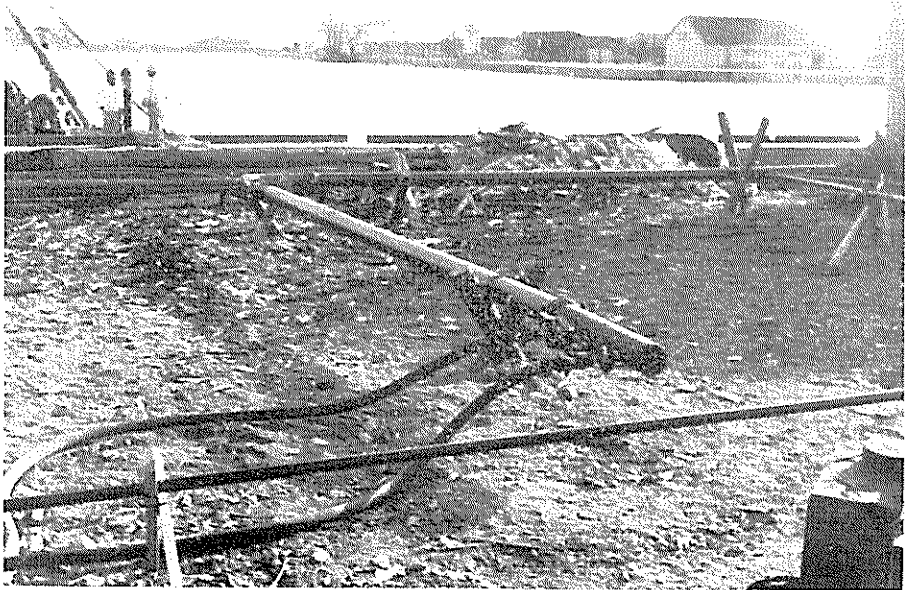
圧さく空気の配管
