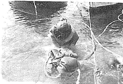
(3) 潜水夫による施工予定位置の均しおよび清掃作業 (田後港防波堤工事)
