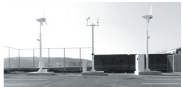
図-3 発電用風車と風況観測塔 (東側より望む全景)
