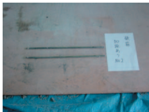
付写真-6.8 供試体からはつり出した鋼材②
