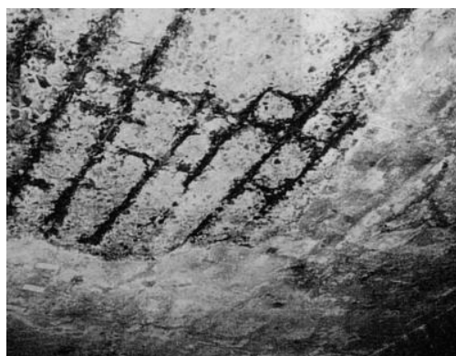
写真-1.1 栈橋上部工(スラブ)における塩害劣化事例(建設後約30年経過)
