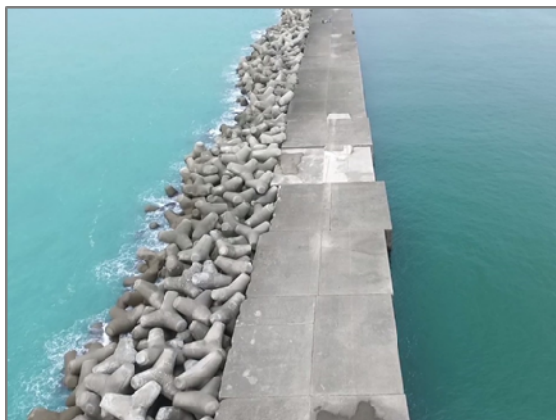
図-1.1.3.2 防波堤のずれ(高度約 30m)
