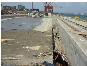
写真-2.3.1.2 岸壁の被災状況
