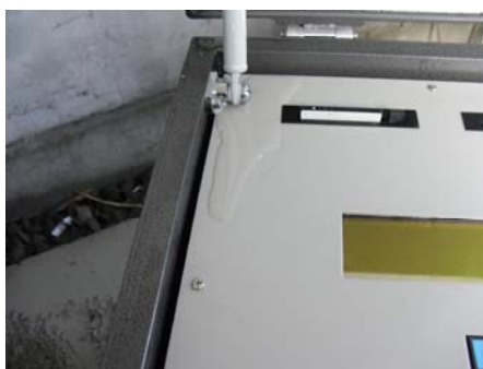
写真-2.1.2.1 八戸港の強震計の躯体内部に残されていた海水
