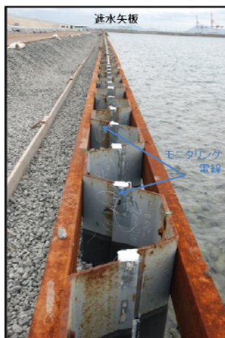
写真-2.1.1.7 廃棄物海面処分場の遮水工
