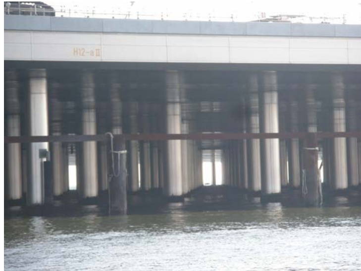
写真-2.1.1.6 東京国際空港（羽田空港）D滑走路の棧橋部分 （100年間の防食を可能としたステンスライニングされた鋼管杭が用いられている。）
