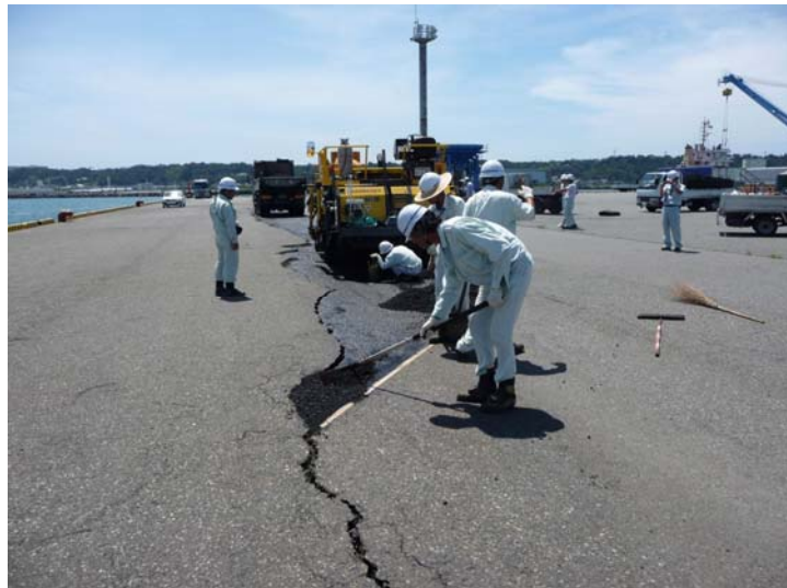
写真-2.1.2.1 平成 21 年 8 月 11 日駿河湾の地震による御前崎港の被害
