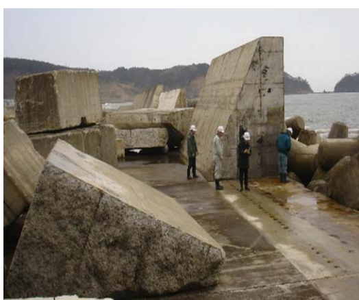
写真-2.1.4.6 長周期うねりによる越波被害
