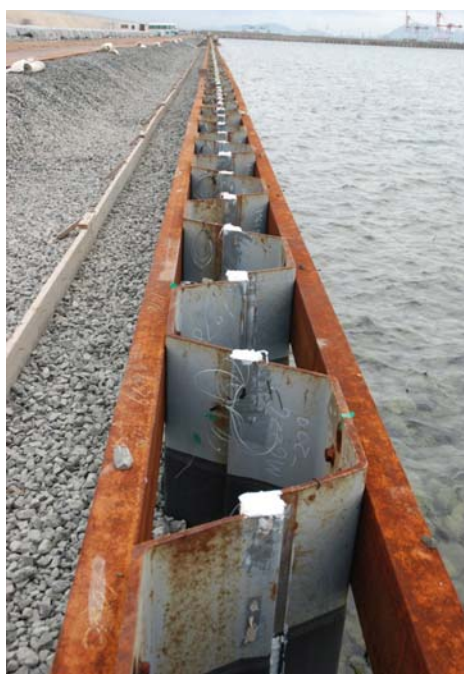
写真-2.1.1.11 研究対象としている遮水壁（北九州港） (写真中央の連続矢板壁で遮水を行っており、施工中の工事記録等を検討して、供用後のモニタリング箇所などを検討中である)
