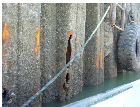
写真-2.1.1.13 鋼矢板の腐食による穴あき
