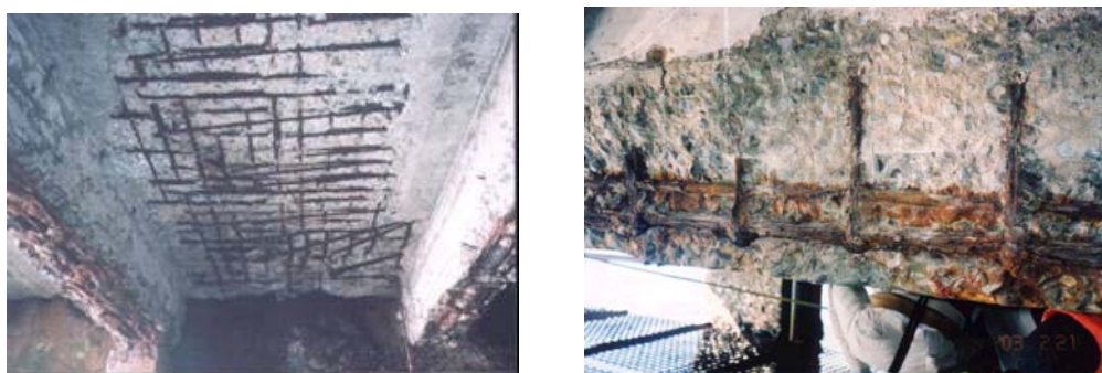
写真-2. 1. 22 栈橋上部工の劣化事例
