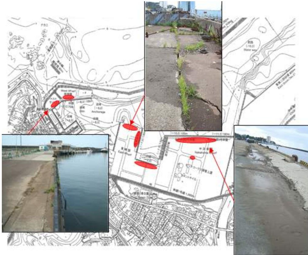
図-2.1.10 新潟県中越沖地震における液状化被害状況（柏崎港）
