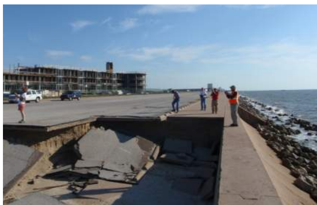
写真-2. 2. 24 ガルベストン海岸護岸の被災状況
