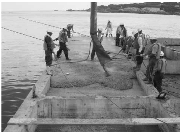
写真-2. 1. 30 ケーソン蓋へのシェルコンクリートの打設試験施工
