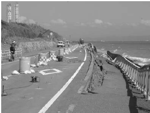
野比海岸の道路の陥没
