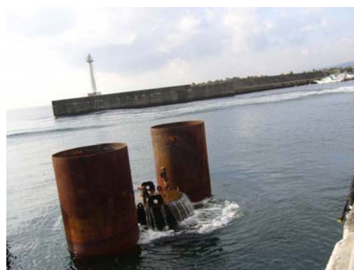
堤体浮上の様子
