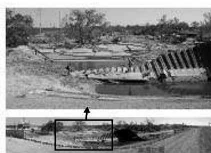
運河堤防の破堤状況
