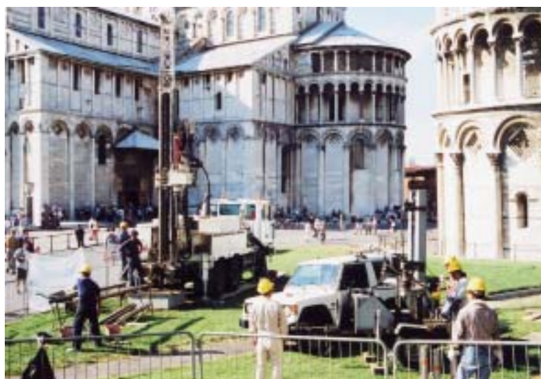
写真 - 2. 2. 1 ピサの斜塔周辺で研究所の研究者が現地の技術者等と共同して行った地盤調査の実施状況
