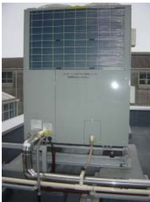
写真-2 ガス式空調機器の外部熱交換機ユニット
