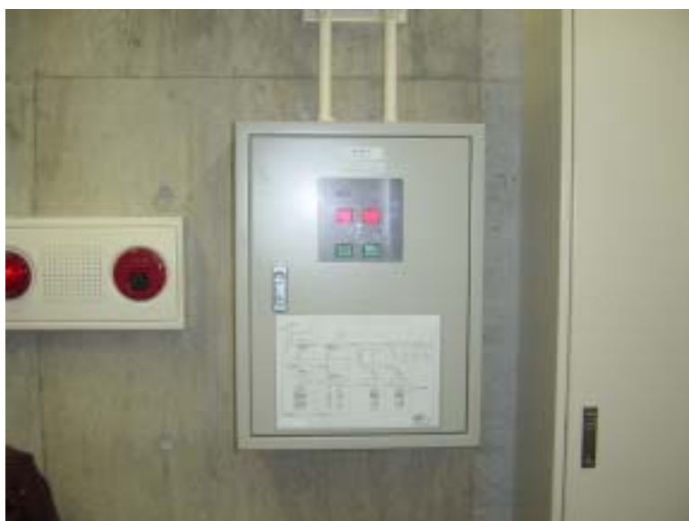
写真- 1 遠隔操作スイッチ設置状況
