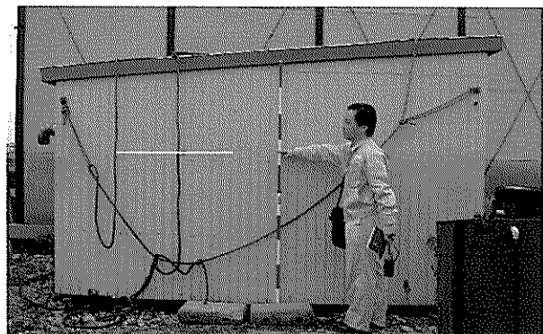
写真-20 写真-19の建物前の倉庫に残る水跡
