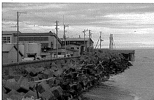
写真-12 写真-10 の施設背後の防潮堤と消波工上の丸太
