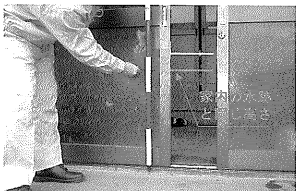
写真-11 写真-10 の施設の玄関に残る2本の水跡
