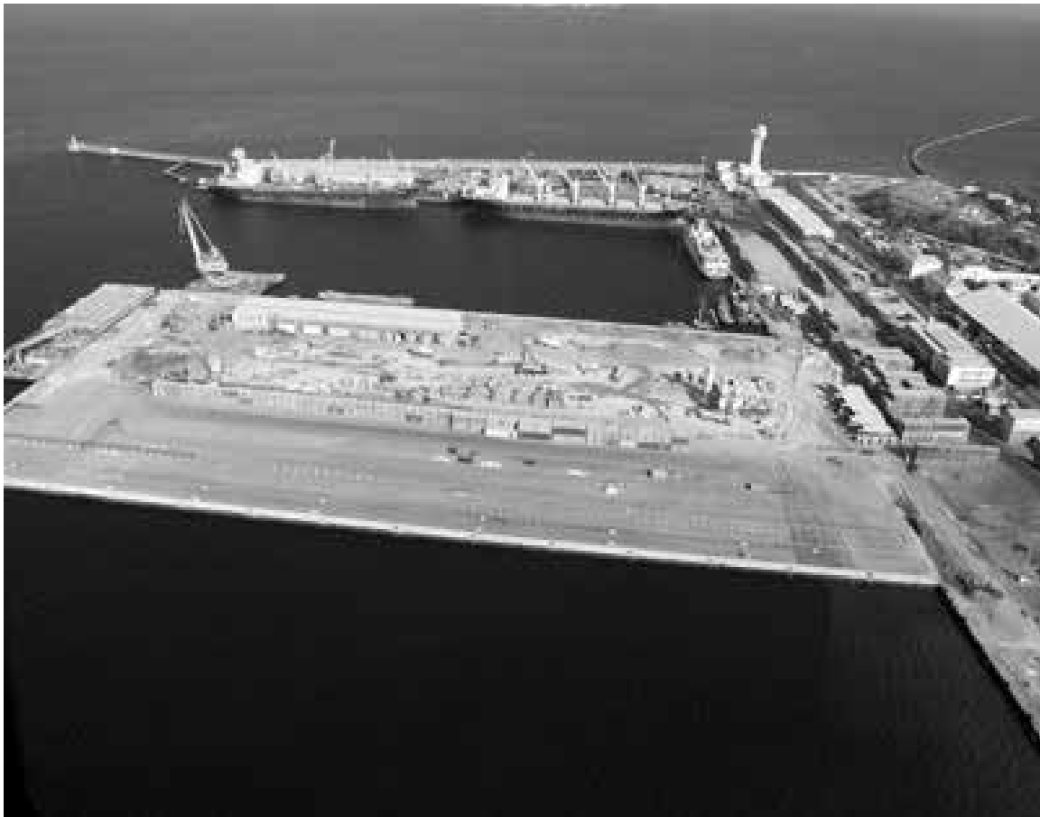
ダカール港・第2埠頭更新プロジェクト建設サイト（航空写真）
