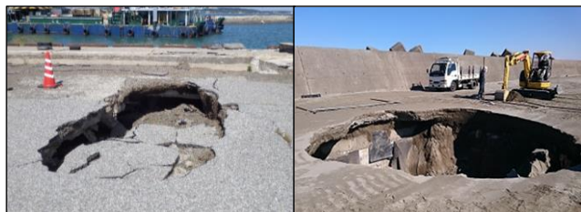
図-1.1 護岸岸壁背後地盤の陥没事例(右:石川県珠洲市飯田港(2024年撮影),左:新潟県(2017年撮影) 5) )
