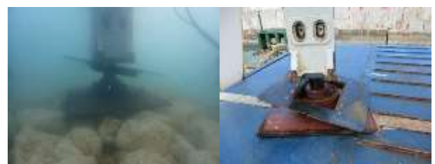
図-5.6 制振板の脱落の様子
