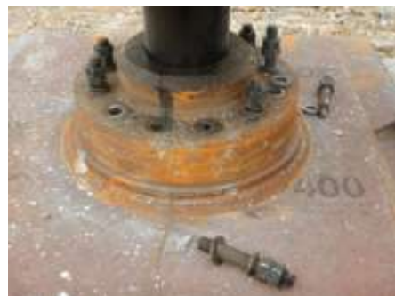
図-4.12 ボルトの破断状況
