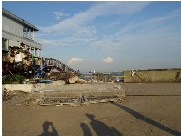
写真-5.6 調査地点① パラペットの倒壊状況
