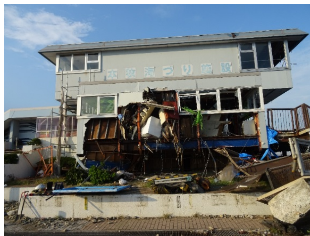
写真-5.7 調査地点①A 本牧海づり施設の被災状況
