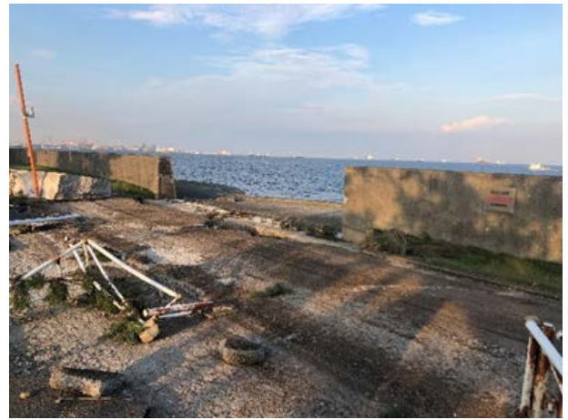
写真-5.12 調査地点⑦ パラペットの倒壊状況
