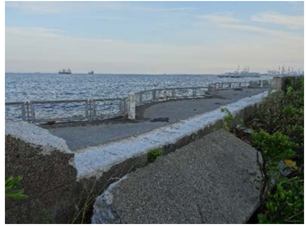
写真-5.10 調査地点⑤ パラペットの倒壊状況
