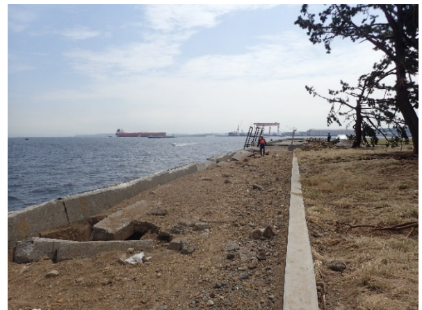
写真-5.1 福浦地区の被災した護岸
