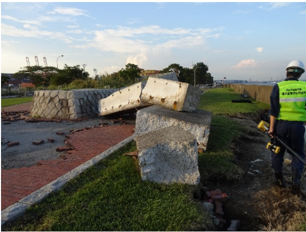
写真-5.11 調査地点⑥ パラペットの倒壊状況
