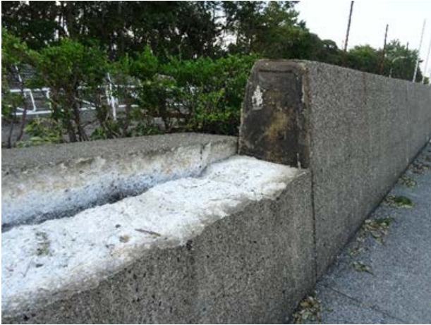
写真-5.9 調査地点② パラペットの倒壊状況
