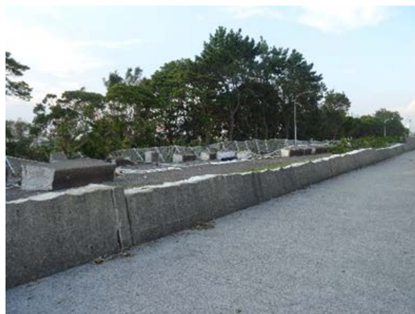
写真-5.8 調査地点② パラペットの倒壊状況
