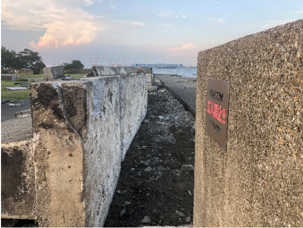
写真-5.15 調査地点⑧ パラペットの倒壊状況
