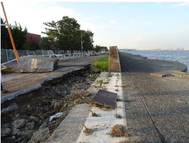
写真-5.13 調査地点⑦ パラペットの倒壊状況
