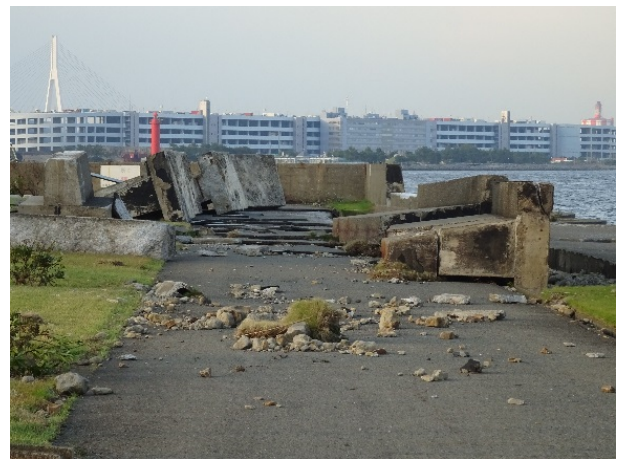
写真-5.14 調査地点⑧ パラペットの倒壊状況
