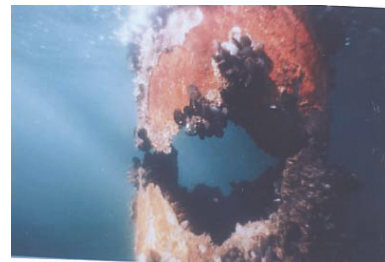
図-1.1 M.L.W.L.直下付近の集中腐食 (鋼管杭の場合)
