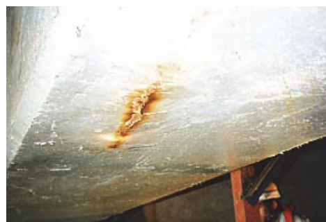
図-5.2 表面被覆適用後の再劣化事例（腐食ひび割れが発生）
