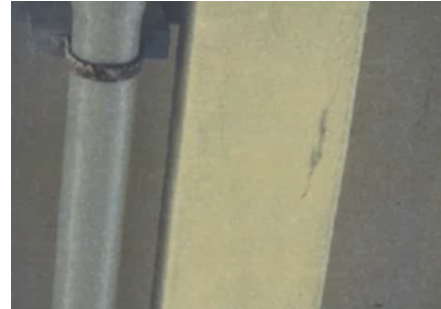
図-3.11 腐食ひび割れと推測されるひび割れ (P2-P3 桁)
