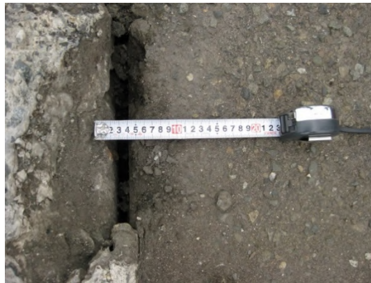
写真-6.1 鋼管矢板の上部工背後の開き
