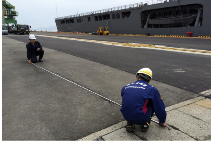
写真-6.10 コンクリート製の側溝を起点とするクラック
