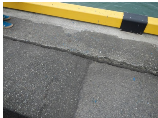
写真-6.8 アスファルト舗装の補修跡
