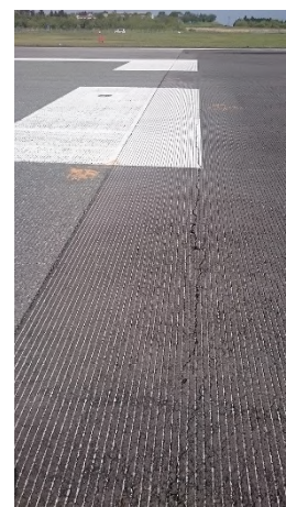
(b) ひび割れ 2
