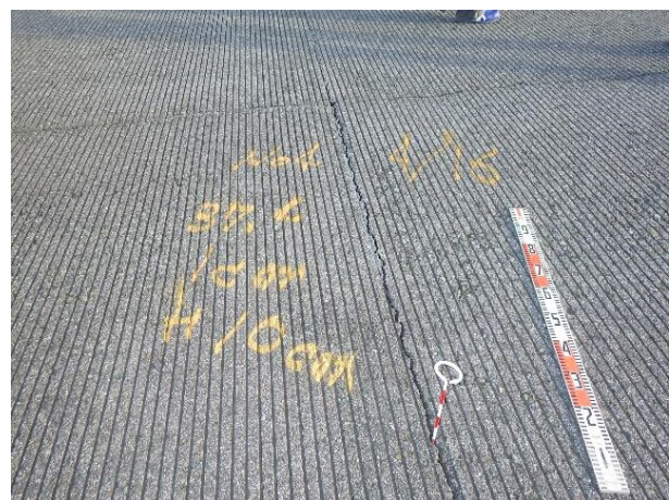
(d) ひび割れ 4
