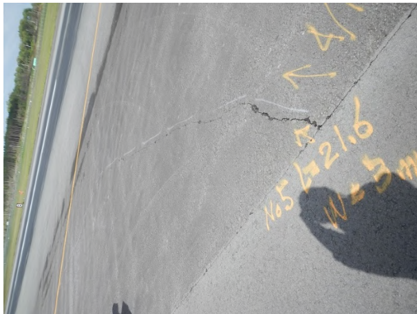
(a) ひび割れ 5
