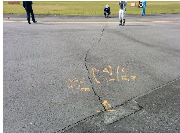
(b) ひび割れ 6
