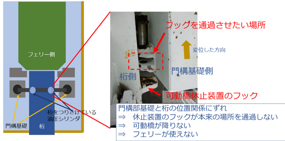
図-4.4 不具合の生じた休止装置部分（写真は 2016 年 4 月 16 日撮影）
