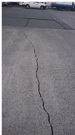
(b) ひび割れ西
