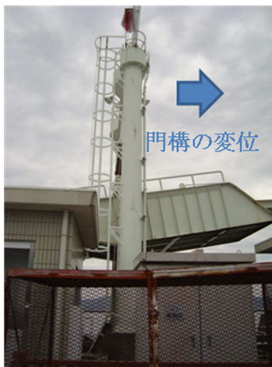
写真-4.5 門構の変位の向き（2016年4月16日撮影）（写真右手が西）
