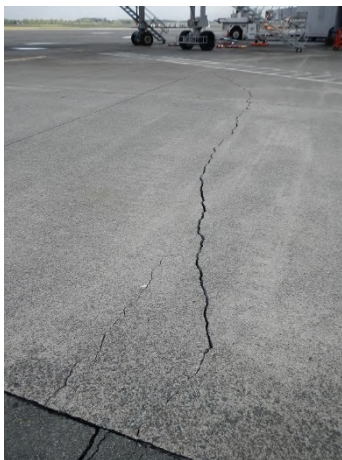
(a) ひび割れ西
