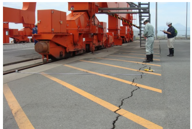
写真-4.2 岸壁（-7.5m）（図-4.1の①）背後の陸側クレーンレール基礎の陸側に生じたクラック（2016年4月16日撮影）
