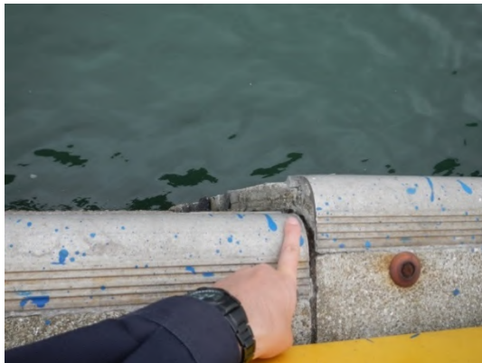
写真-6.5 上部工のずれ
