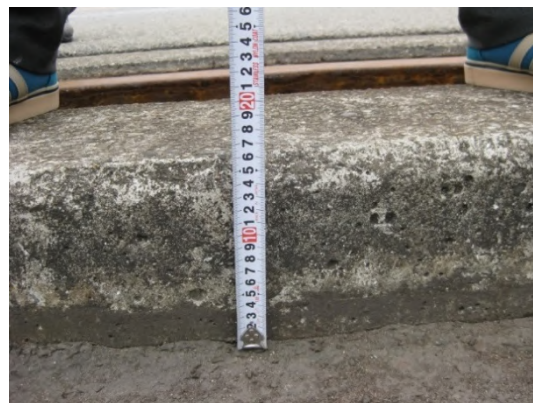
写真-6.2 鋼管矢板上部工～クレーン基礎間のアスファルト舗装の沈下
