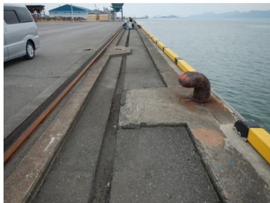
写真-6.7 岸壁上部工～クレーン基礎間の アスファルト舗装の沈下
