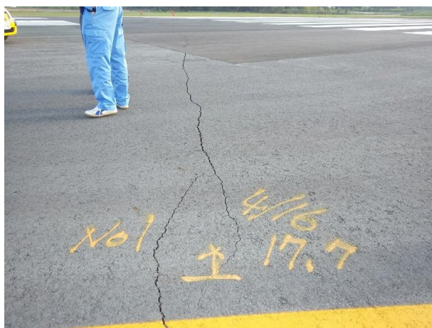
(a) ひび割れ 1
