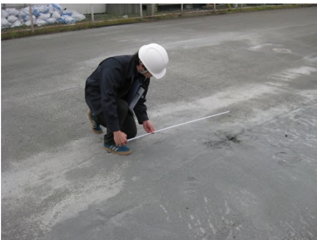
写真-6.11 大島地区道路の噴砂（噴砂は中央右側と奥の2箇所）
