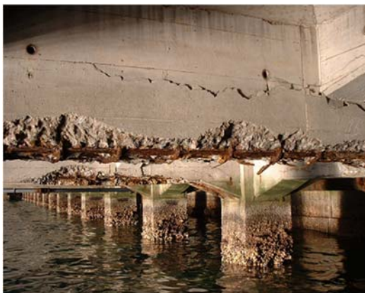
図-1.1 栈橋上部工はり部材における塩害の様子
