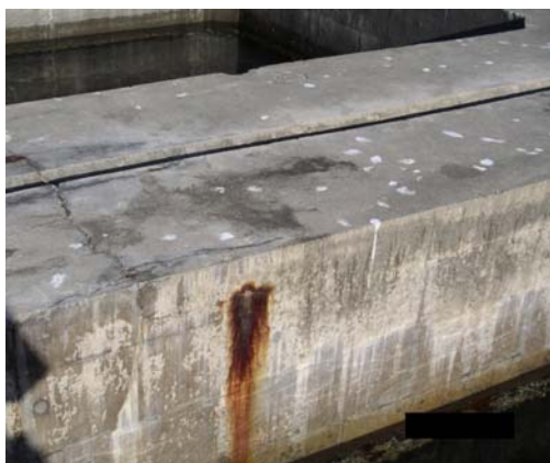
付図-D.1 スリットケーソンでの塩害事例
