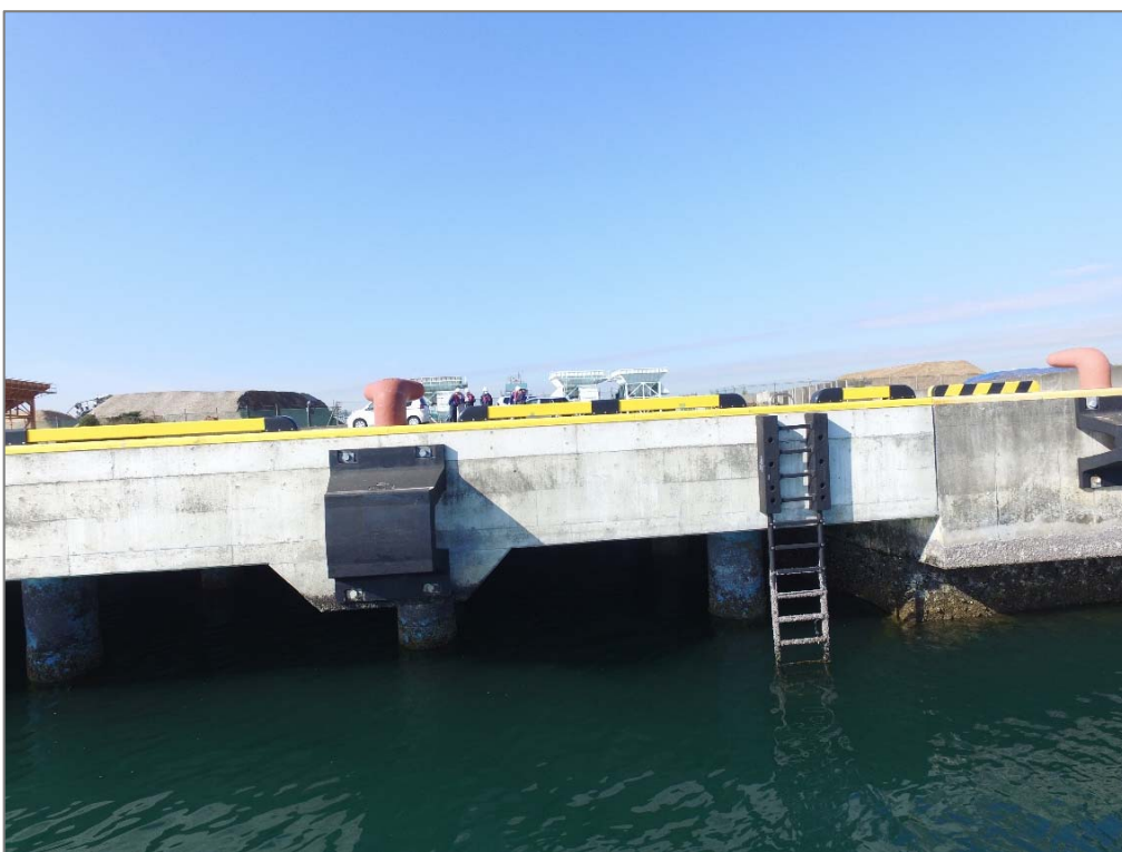
写真-4.20 附帯設備(高度約1m)
