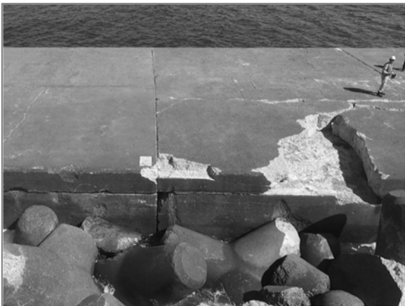
写真-4.6 上部工の欠損(高度約 10m)
