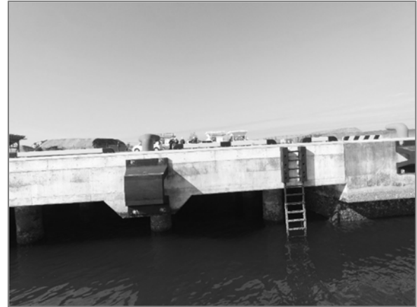
写真-4.20 附帯設備(高度約1m)
