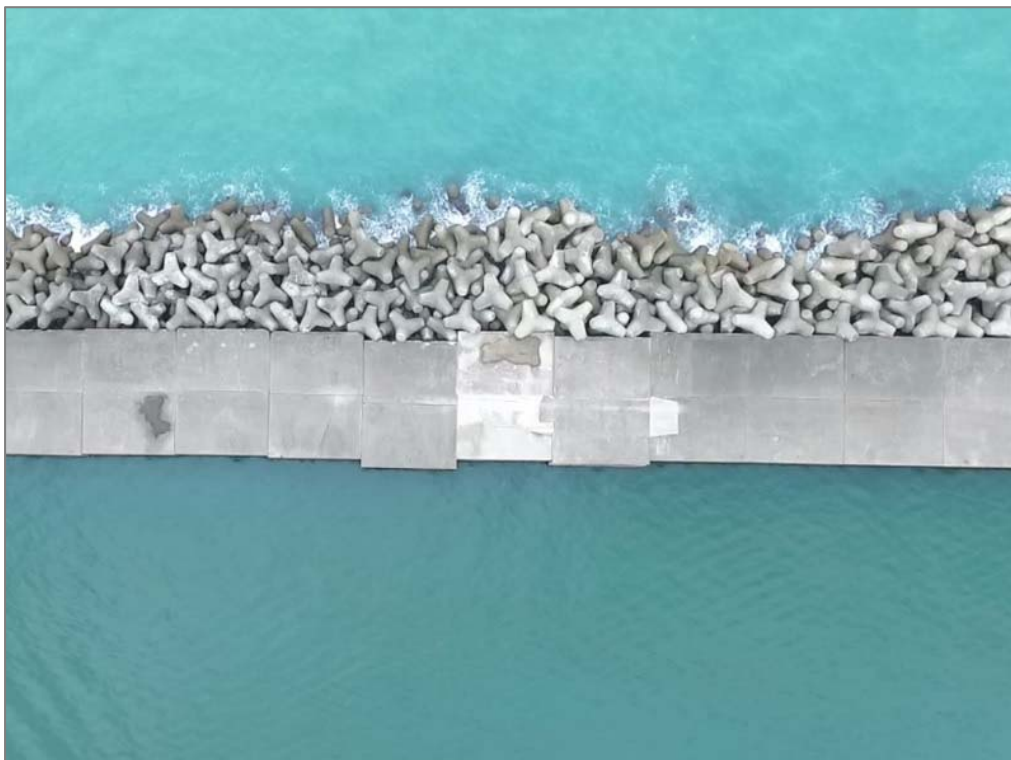
写真-4.5 防波堤のずれ(高度約60m)
