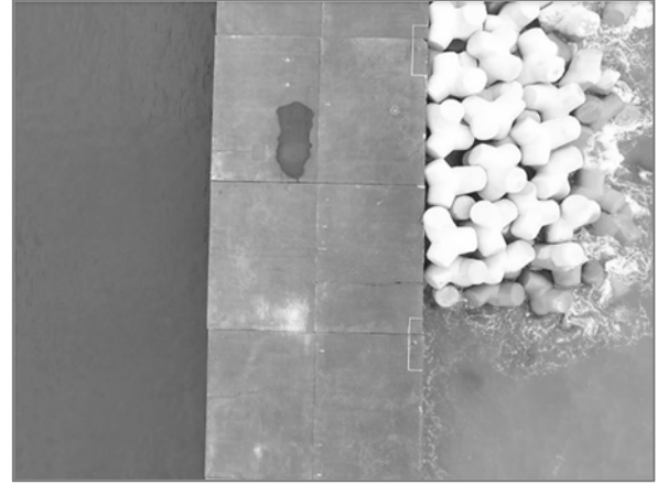
写真-4.7 上部工のひび割れ(高度約 50m)
