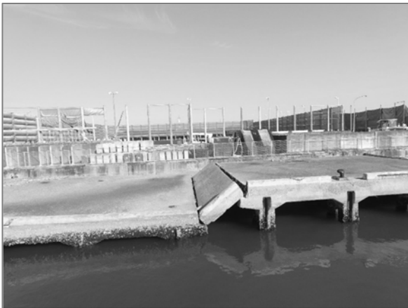
写真-4.19 鋼管杭の著しい劣化・損傷で落下した 栈橋上部工(高度約4m)
