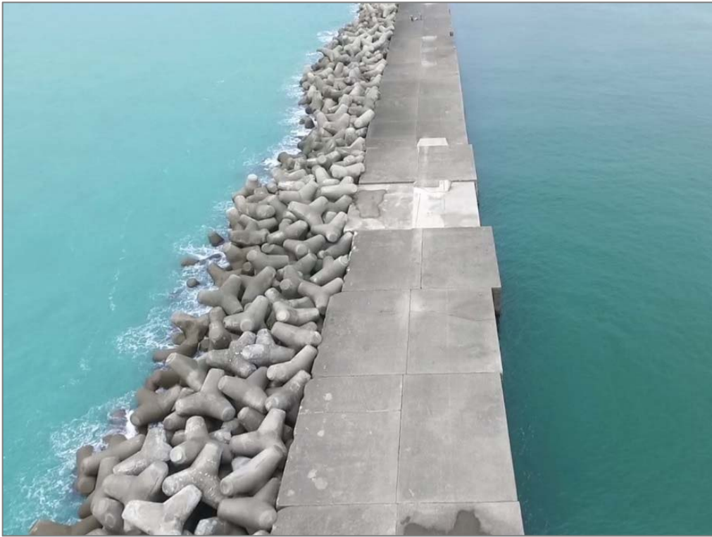
写真-4.4 防波堤のずれ(高度約30m)
