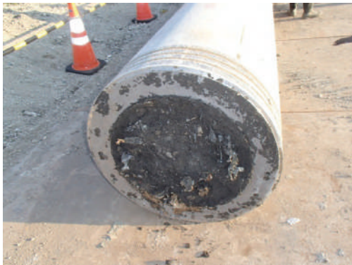
付録写真-2.5 杭内部の閉塞状態
