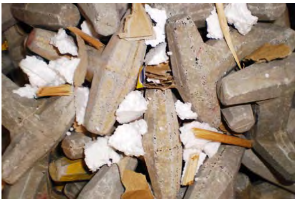
写真-3.3 ブロック間がゴミで閉塞した状態（上方より）
