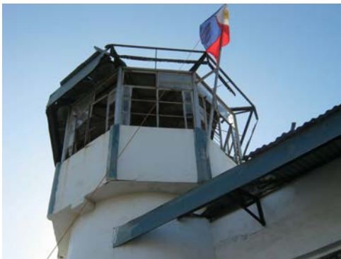
写真-5.22 風で破損した見張所（クラシ港）
