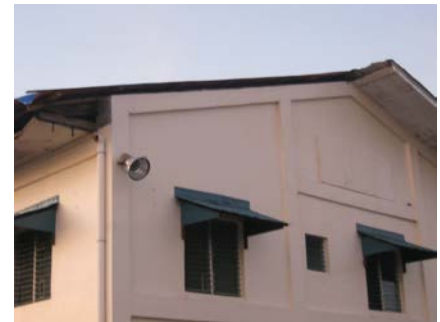
写真-5.7 港湾運営事務所の屋根の一部が破損 (ドマギット港)
