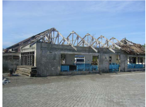
写真-5.31 風により被災した旅客待合所 (リパタ港)
