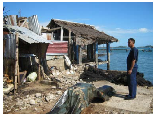
写真-5.3 破壊された木造倉庫（エスタンシア港）
