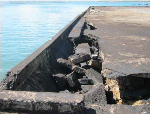
写真-4.7 エスタンシア港（港湾公社）の吸い出された護岸
