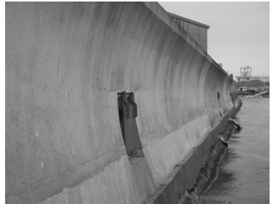
(a) フラップゲート付き排水口
