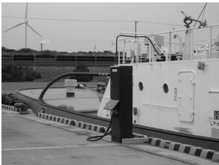
写真-A.4 陸電施設
