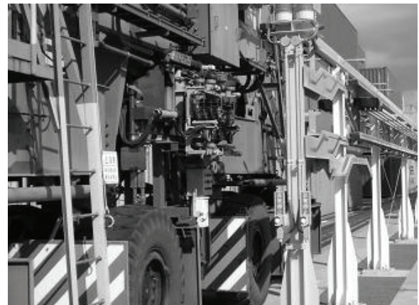
写真-2.2 トランスファークレーン（RTG）の集電装置
