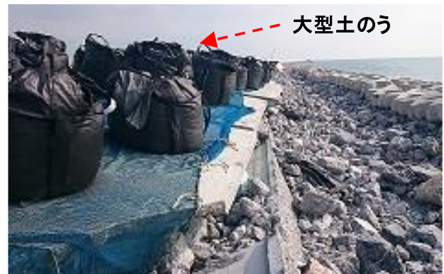
図-1.1 護岸被災後に仮設材として用いられた土のう
