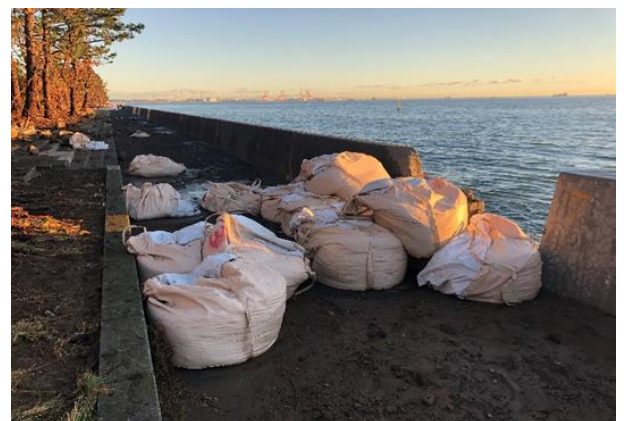
図-1.4 2019年台風15号の応急復旧として設置された土のうが台風19号の襲来で散乱した状況
