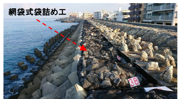
図-1.2 護岸天端の被災後に設置された網袋式被覆工
