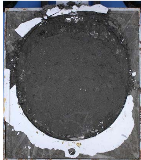
a) 上方からの観察 (コンクリート材除去後)
