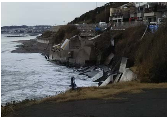
図-1.1 高波で被災した護岸の例
