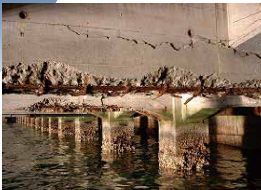
老朽化する港湾施設（塩害により劣化した橋上土工）
