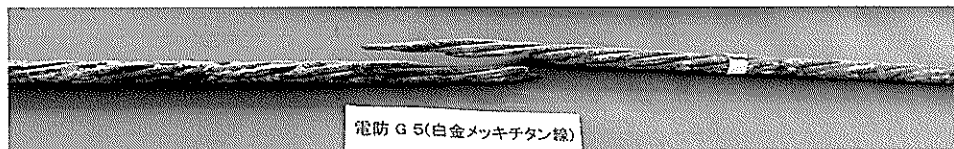
写真-7 チタン線方式の鋼材の腐食状況
