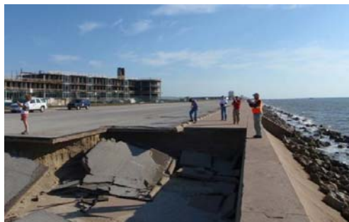
写真-2.2.8.11 ガルベトン海岸護岸の被災状況
