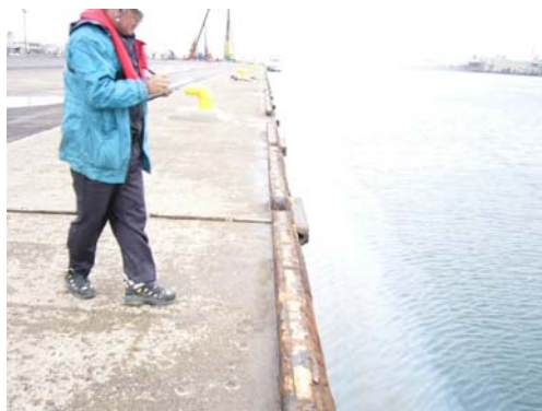
写真-2.1.1.4 二段タイ施工岸壁の状況(地震後)
