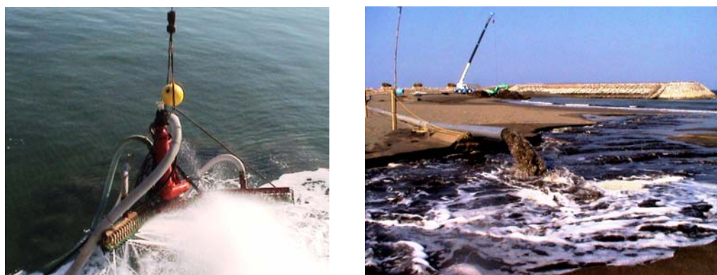
写真-2.1.1.14 宮崎港における実証実験（平成 21 年 4 月 24 日） （左：有孔管簡易浚渫装置、右：排砂状況）
