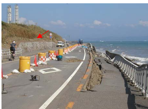
野比海岸の道路の陥没
