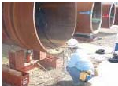
写真-2.1.1.1 羽田D滑走路用鋼管杭への光ファイバーセンサーの設置状況
