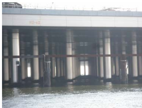
写真-2.1.1.17 東京国際空港（羽田空港）D滑走路の棧橋部分 （100年間の防食を可能としたステンスライニングされた鋼管杭が用いられている。）
