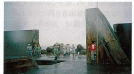
岩手県久慈港半崎（はんざき）地区の護岸被害
