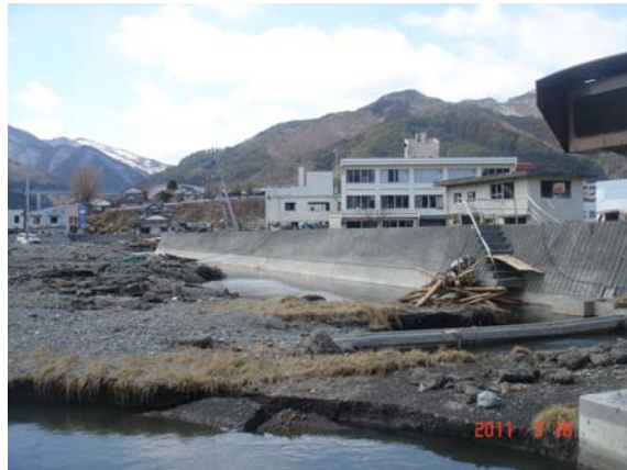
写真-13 洗掘された防潮壁
