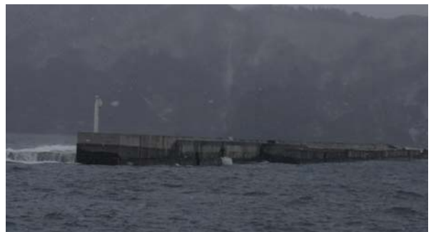
写真-6 釜石湾口防波堤 残った南堤の一部
