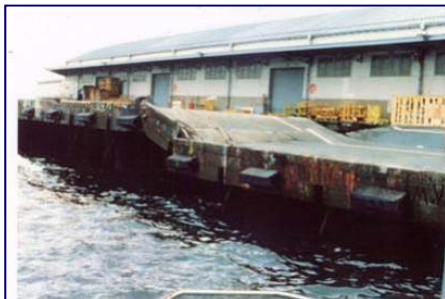
栈橋上部工の崩落
