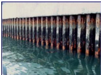
矢板式岸壁の鋼材腐食
