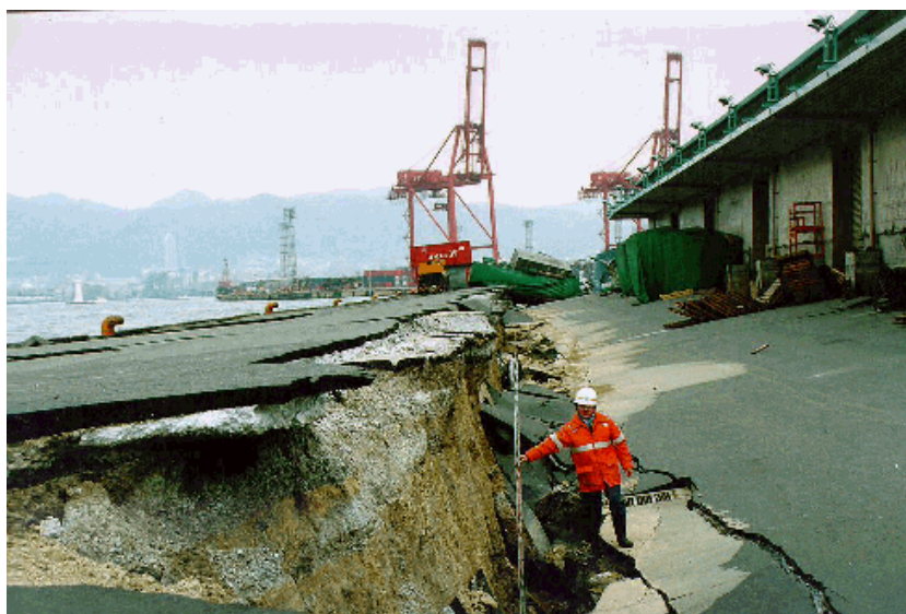
図-4 兵庫県南部地震における重力式岸壁の被害事例 (図-3と比較しやすくするため左右反転させている)
