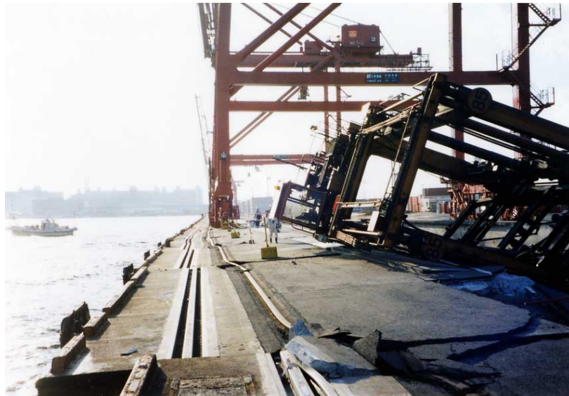
図-1 兵庫県南部地震による神戸港のコンテナバースの被害
