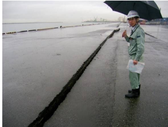
図-5 2005年福岡県西方沖の地震における矢板式岸壁の被害事例 (控え工の位置に現れた段差)
