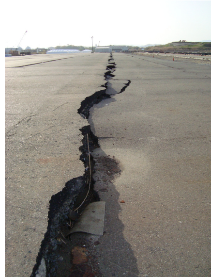
写真-6 小名浜港藤原埠頭岸壁 (-12m) 被災状況
