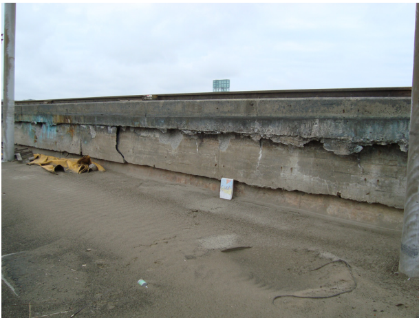
写真-4 小名浜港3号埠頭3-2岸壁の背後における段差 (段差の下端に置かれている紙はA4サイズ)
