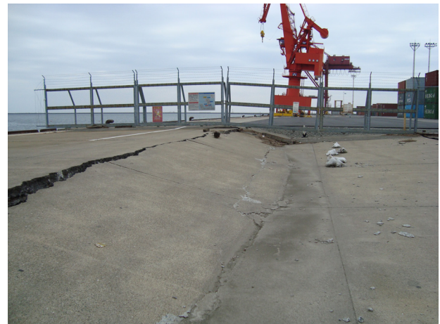
写真-7 小名浜港大剣埠頭岸壁 (-7.5m) 被災状況
