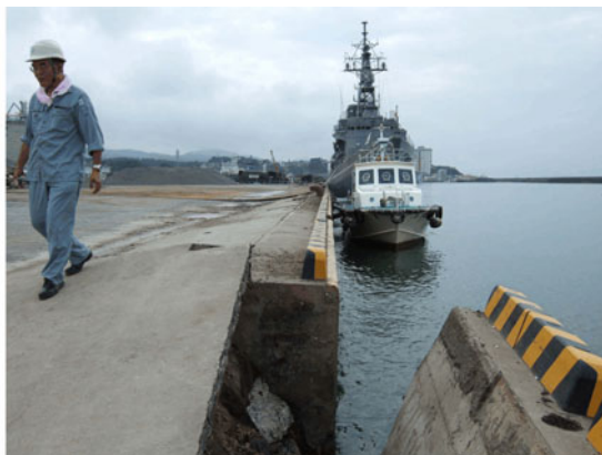
写真1 中浜埠頭3号岸壁の被害
