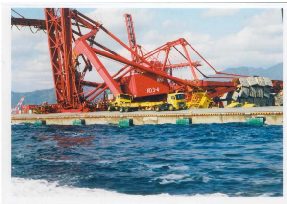
写真-1 1995年兵庫県南部地震の際に倒壊した六甲アイランド南側岸壁のガントリークレーン
