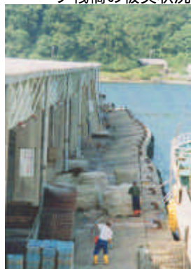
写真-1 境漁港-6.0m 岸壁の被害状況
