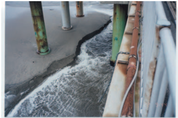
写真-15 海水の流下によってバームに生じた流出溝 (2003年9月)
