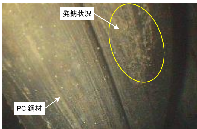
写真-10.2.2 直接目視によるPC鋼材の腐食確認
