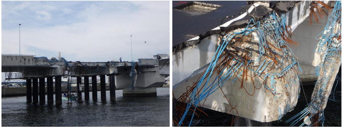
a) 損傷径間の全景 b) 支点部付近の近景 写真-2.2 大型船舶の衝突によるプレキャストPC桁の損傷事例 6)
