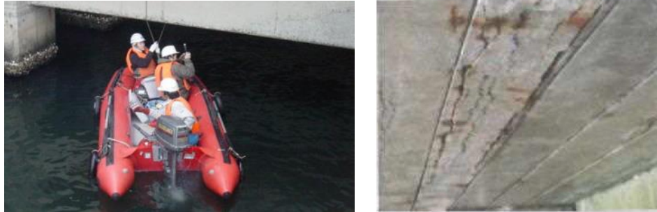
図-10.1.4 点検状況および変状発生箇所写真
