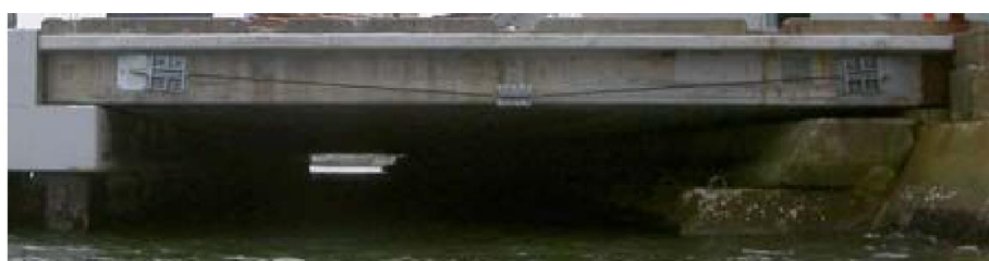
写真-8.1 外ケーブル工法のT桁橋への適用事例 2)の写真-2を一部抜粋
