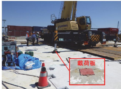
図-10.1.17 現地たわみ計測状況の例（リプレイサブル棧橋の場合） 5)
