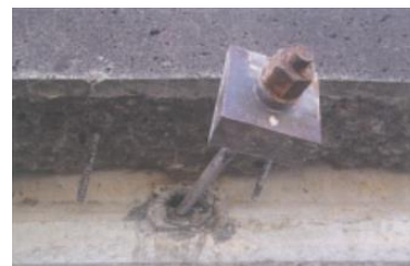
写真-2.1 横締め鋼棒の突出 2)
