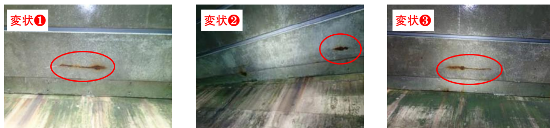
写真-10.2.1 変状発生状況
