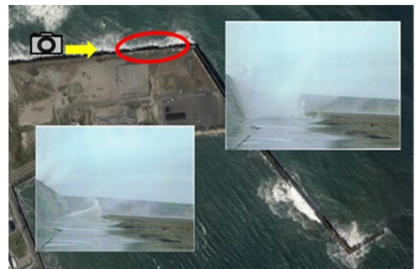
写真-2.4 高波浪時のケーソン目地部透過波：鹿島港
