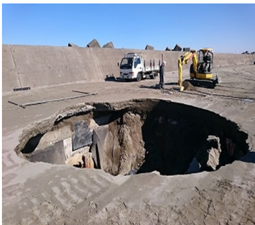
写真-1.1 ケーソン護岸における陥没の発生状況
