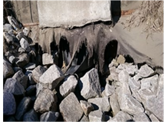
写真-2.1 護岸背後の陥没発生箇所
