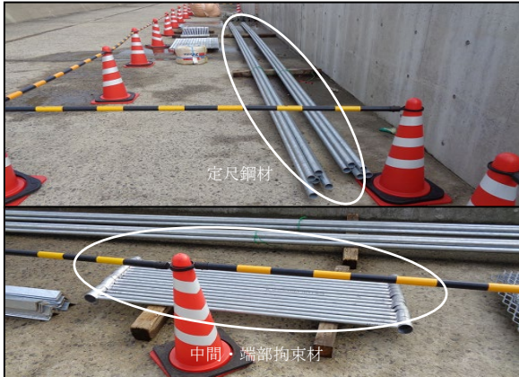
写真-B.33 ガイドパイプ鋼管(上)・中間・端部拘束材(下)
