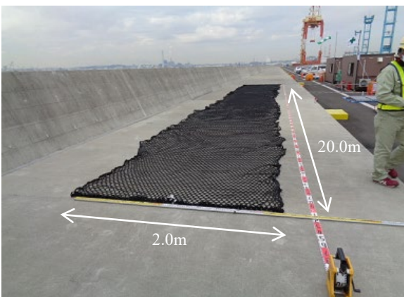
写真-A.22 ネットバッファ全景
