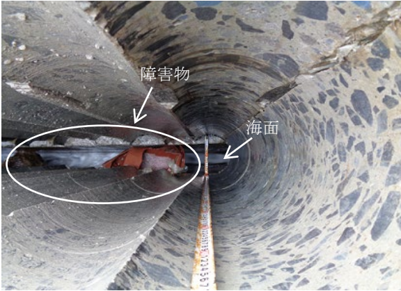
写真-A.8 ケーソン目地間に存在する障害物
