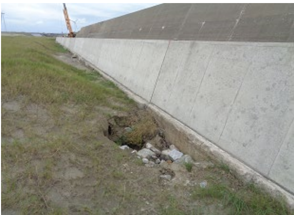
写真-B. 46 これまで慢性的に発生していた陥没
