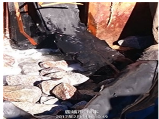
写真-2.2 陥没箇所の損傷防砂板
