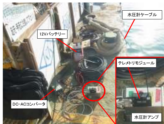
図-5.6 潮位水圧計テレメトリシステム動作試験状況
