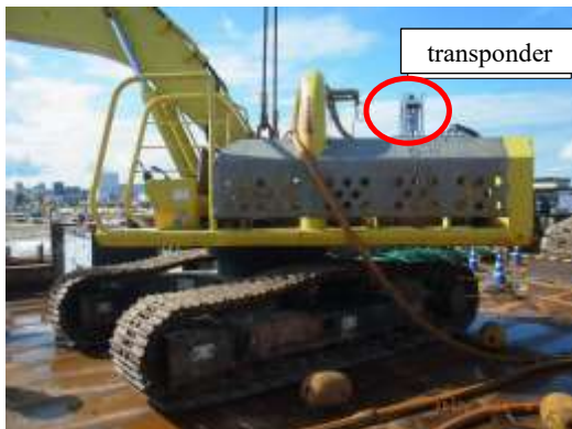
図-3.30 SBL トランスポンダ搭載状況
