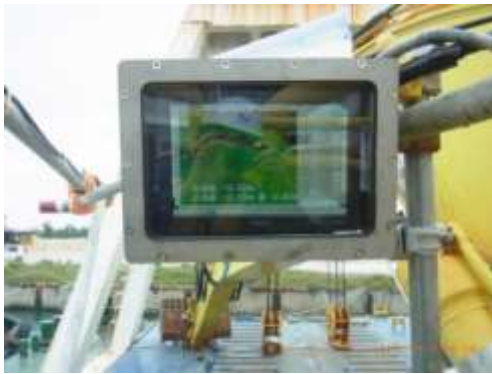
図-5.10 モニタの表示状況
