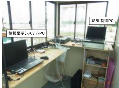
図-5.14 台船上制御室
