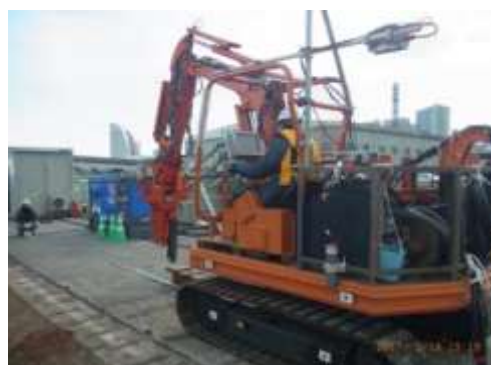
図-4.4 地磁気方位計の設置状況
