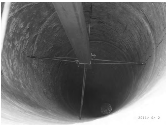
写真-1.2 管壁への接触状況
