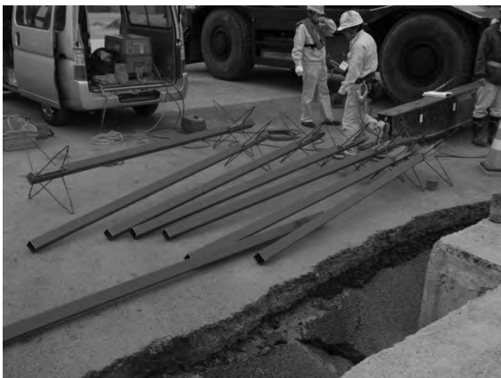
写真-1.1 挿入型傾斜計用ガイド管
