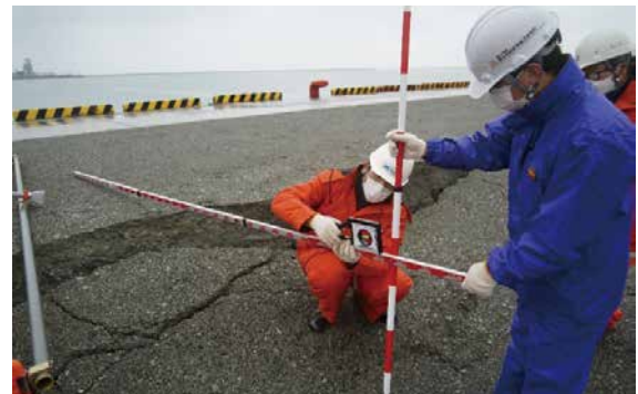
相馬港の被災状況調査
